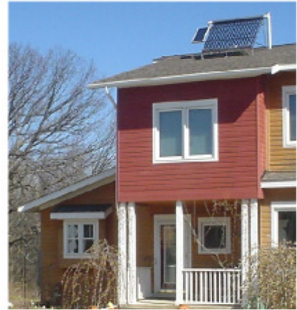
Fig.30.2: Ein solares Warmwassermodul, das heißes Wasser für eine Familie in Michigan bereitstellt. Die Pumpe des Systems wird von dem kleinen PV-Modul links angetrieben.
