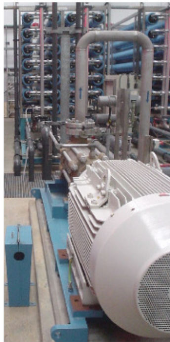
Fig.15.10: Teile der Osmose-Anlage in der Meerwasserentsalzungsanlage auf Jersey. Die Pumpe rechts im Vordergrund hat eine Leistung von 355 kW und schaufelt Seewasser bei einem Druck von 65 Bar in 39 spiralförmige Membranen. Das sind die in Bänken angeordneten waagrechten blauen Röhren (links). Sie liefert 1500 m 3 Trinkwasser am Tag. Das Trinkwasser dieser Anlage verursacht Energiekosten von 8 kWh pro m 3 .
